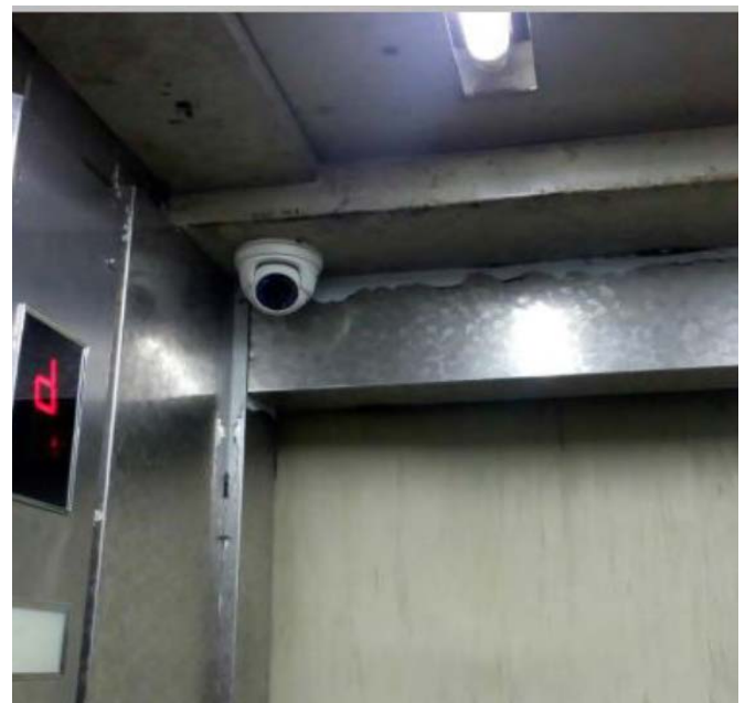
نصب ۴۶ دوربین مدار بسته تحت شبکه در کلیه نقاط حساس ساختمان تغذیه
